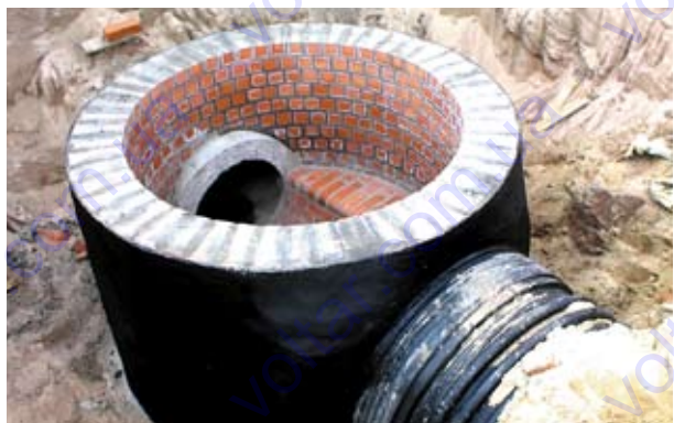
Труба Краф з колодязем виготовленим з цегли
