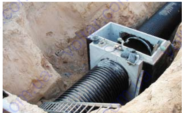
Колектор очисних споруд
