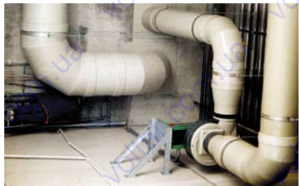
Труби промислової вентиляції
