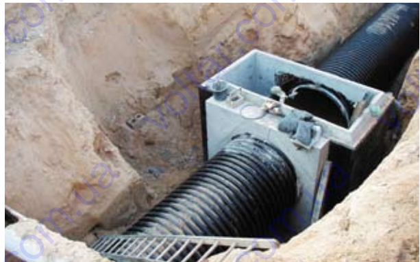
Колектор очисних споруд
