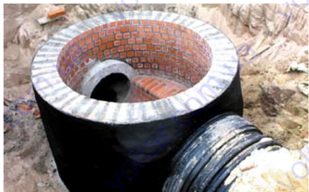
Труба Краф з колодязем виготовленим з цегли
