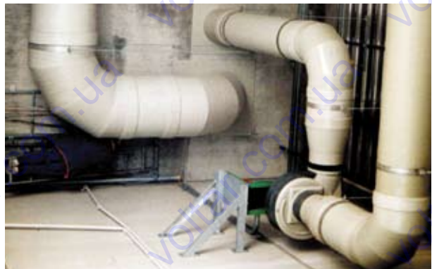
Труби промислової вентиляції
