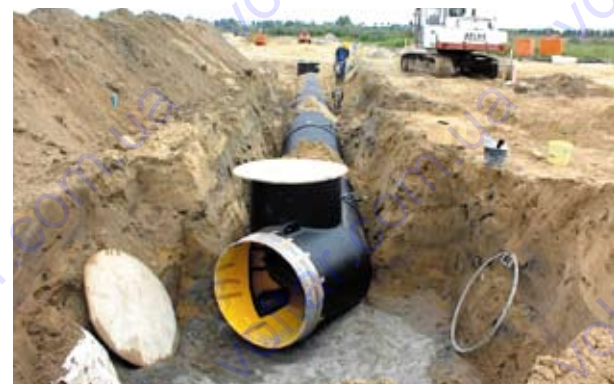
Водовід з відводом і колодязем
