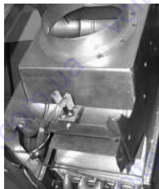
Термостат отработанных газов
